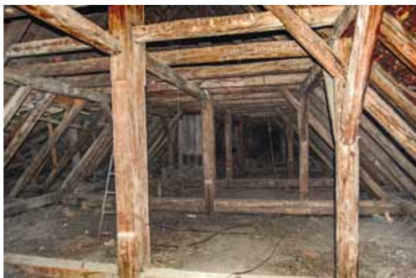
Opätovne poskladaný krov nad školskou budovou kláštora uršulínok na Halenárskej ulici v Trnave, pohľad z juhu na sever
