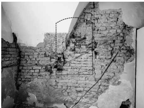
Na južnej fasáde prvého stredovekého murovaného domu na parcele budúceho Adalbertina vyznačený nález okna prekrytého pri vložení muriva dodatočnej klenby prejazdu
